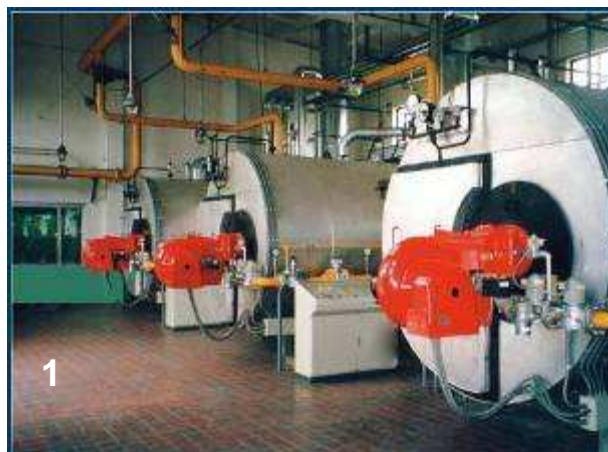
1 Котельная в здании парламента КНР в Пекине
