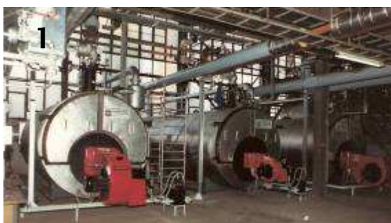
1 Отопительный комплекс 17Мвт Франкенберг город Кемниц, Германия
